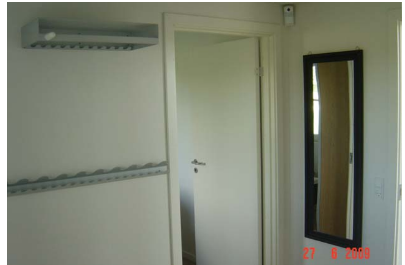
Entré, til- og frakobling af tyverialarm med billede overføring.
